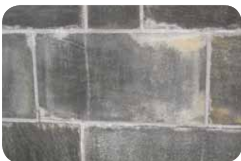
Eksempel på salt- og kalkutslag.
