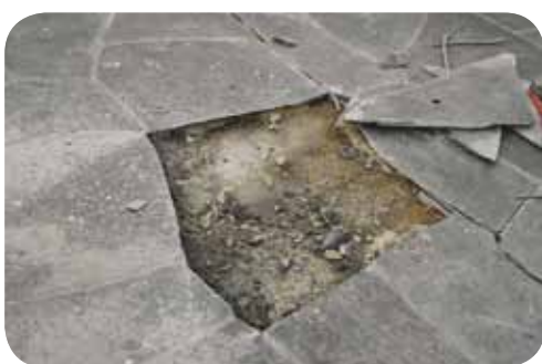
Eksempel på frostsprengning.
