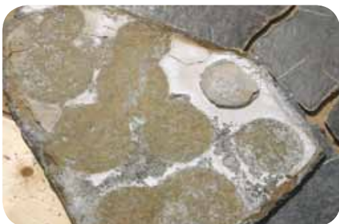
Eksempel på dårlig limdekning.
