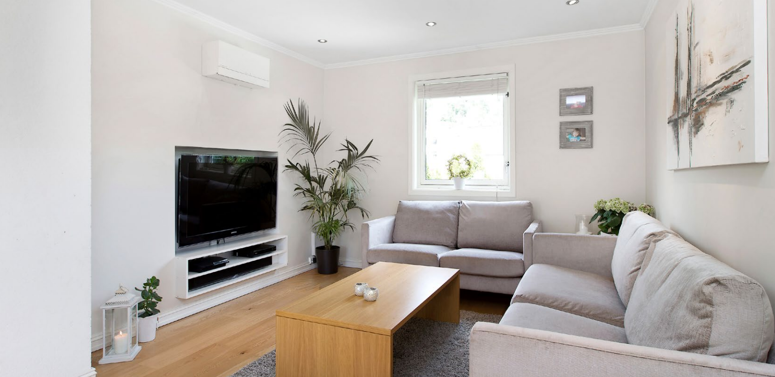
Miniventilasjon montert i stuen
