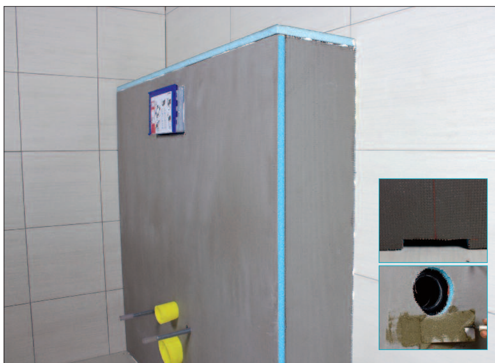
Lag dremsåpning og forsterkning. Toalettplaten er klar for flislegging når limet har tørket.
